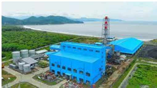
Gambar 2. Sistem Pembangkit Listrik Tenaga Uap di Kabupaten Sumbawa Barat
