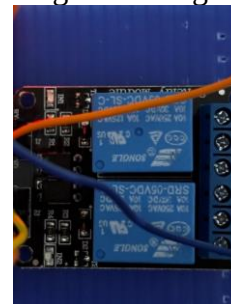
Gambar 8. Relay high ketika sensor api tidak mendeteksi adanya api dan keadaan ruangan Gudang normal Sumber : Penulis (2025)
